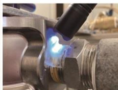
施工イメージ | エア漏れ
